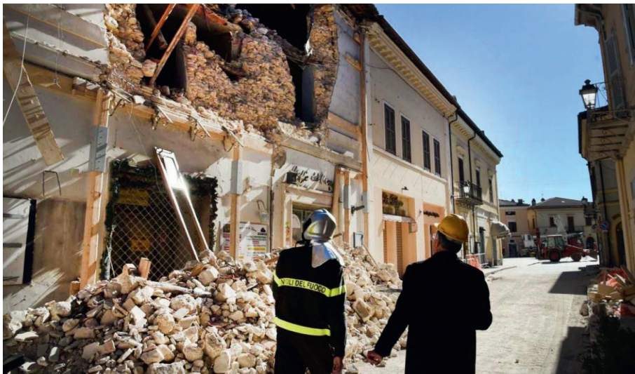
Последствия землетрясения ( https://pxhere.com )
