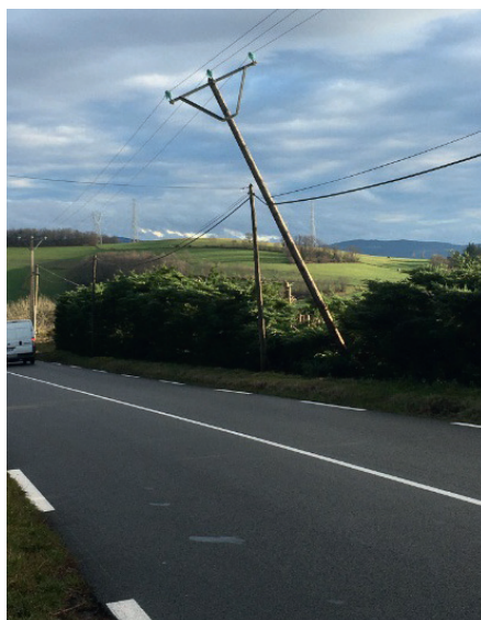
Последствия шторма ( http://earth-chronicles.ru )
