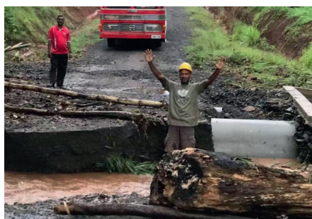
Разрушенная дорога ( https://nnst1.gismeteo.ru )
