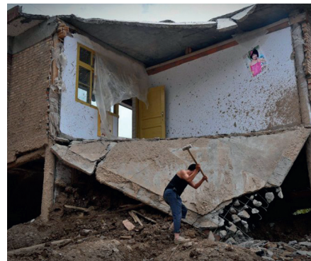
Пострадавшее здание ( https://24warez.ru/uploads/posts/1281531090_china_tragedy_16.jpg )
